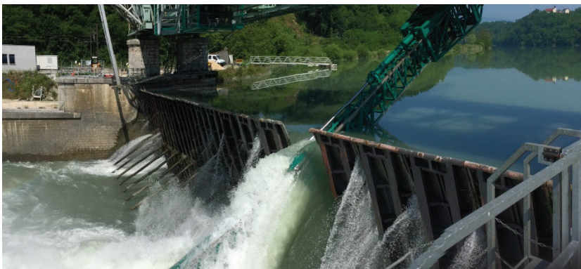
Maneuvered doors to manage water circulation Portes manœuvrées pour gérer la circulation de l'eau Bedienung der Schleusen und Dämme zur Wasserregulierung.
